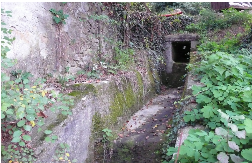
Figura 4.8 Fotografia del Cunettone in prossimità dell'attraversamento della via vicinale ex via Ducale, in parte ricostruito dopo le forti piogge del novembre 2008.
